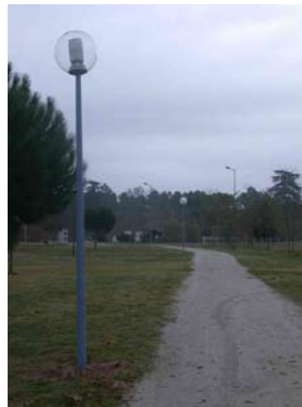
Exemple de luminaire banalisant à Maillas (éclairage autant vers le ciel que la chaussée)
